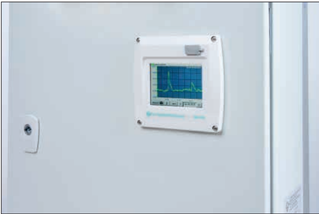
montaje en el armario de distribución
