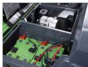
DUAL POWER CON MOTOR DIESEL
