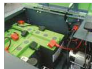
ALOJAMIENTO DE BATERÍAS (1250 E)
