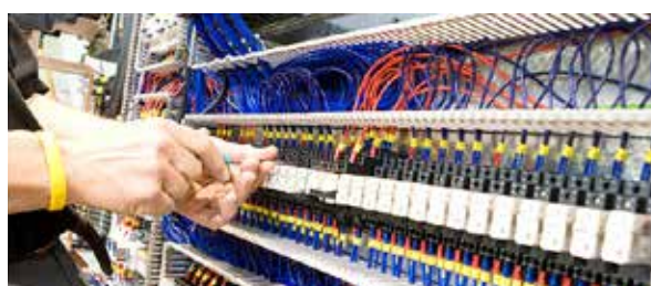
CUADROS ELÉCTRICOS ELECTRIC PANELS
